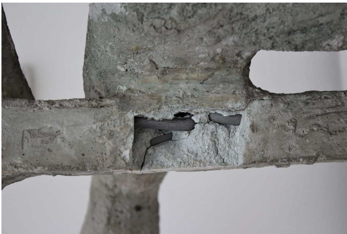
Obr. č. 42. Ošetřená armatura v horní části zadní strany překážky
