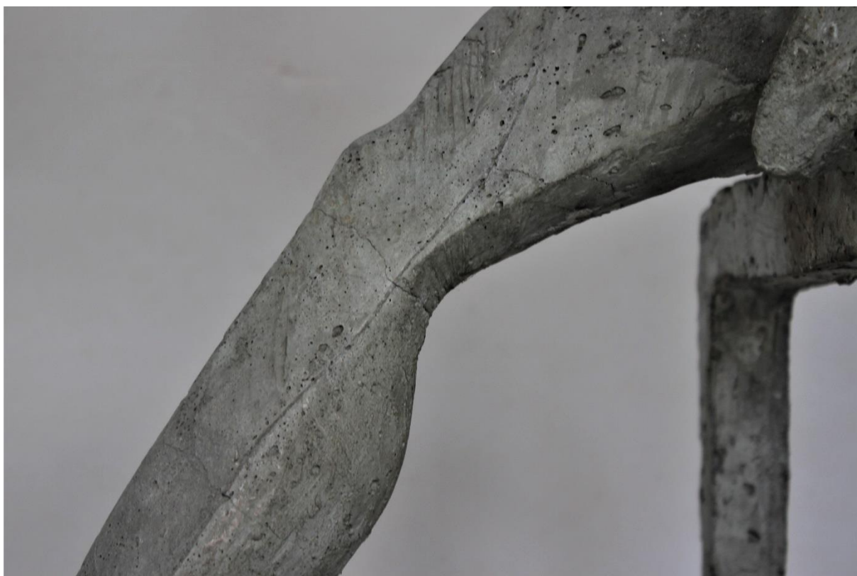
Obr. č. 16. Levá noha sochy – trhlina pod kolenem
