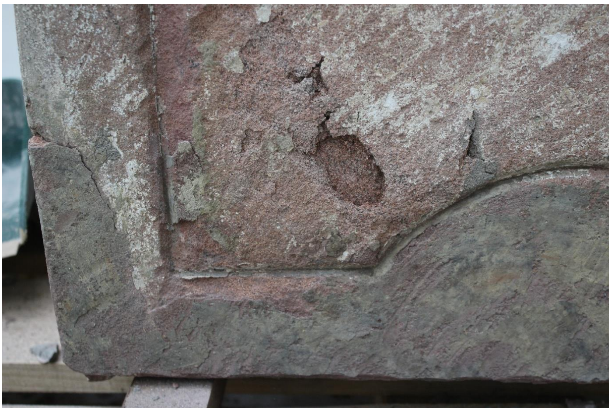
Obr. č. 18. Zde byly odebrány vzorky pro stanovení obsahu vodorozpustných solí
