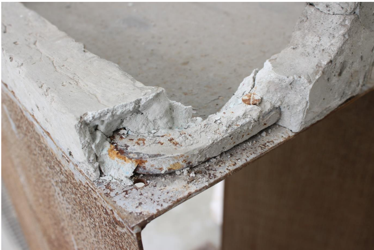
Obr. č. 23. Odhalená armatura ve spodní části překážky
