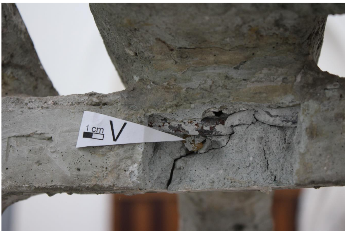
Místo odběru vzorku č. 5. zadní horní část překážky – lepidlo u kovové armatury
