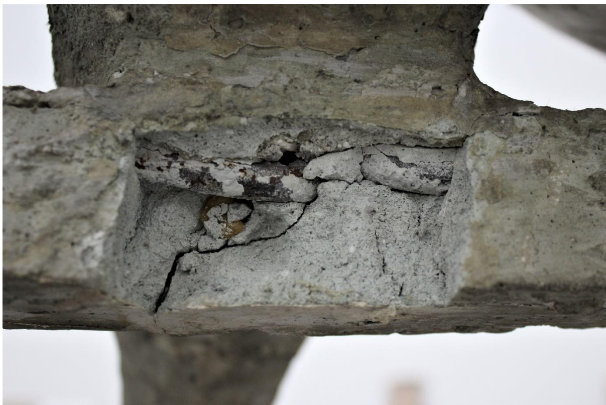
Obr. č. 21. Odhalená armatura v horní části zadní strany překážky
