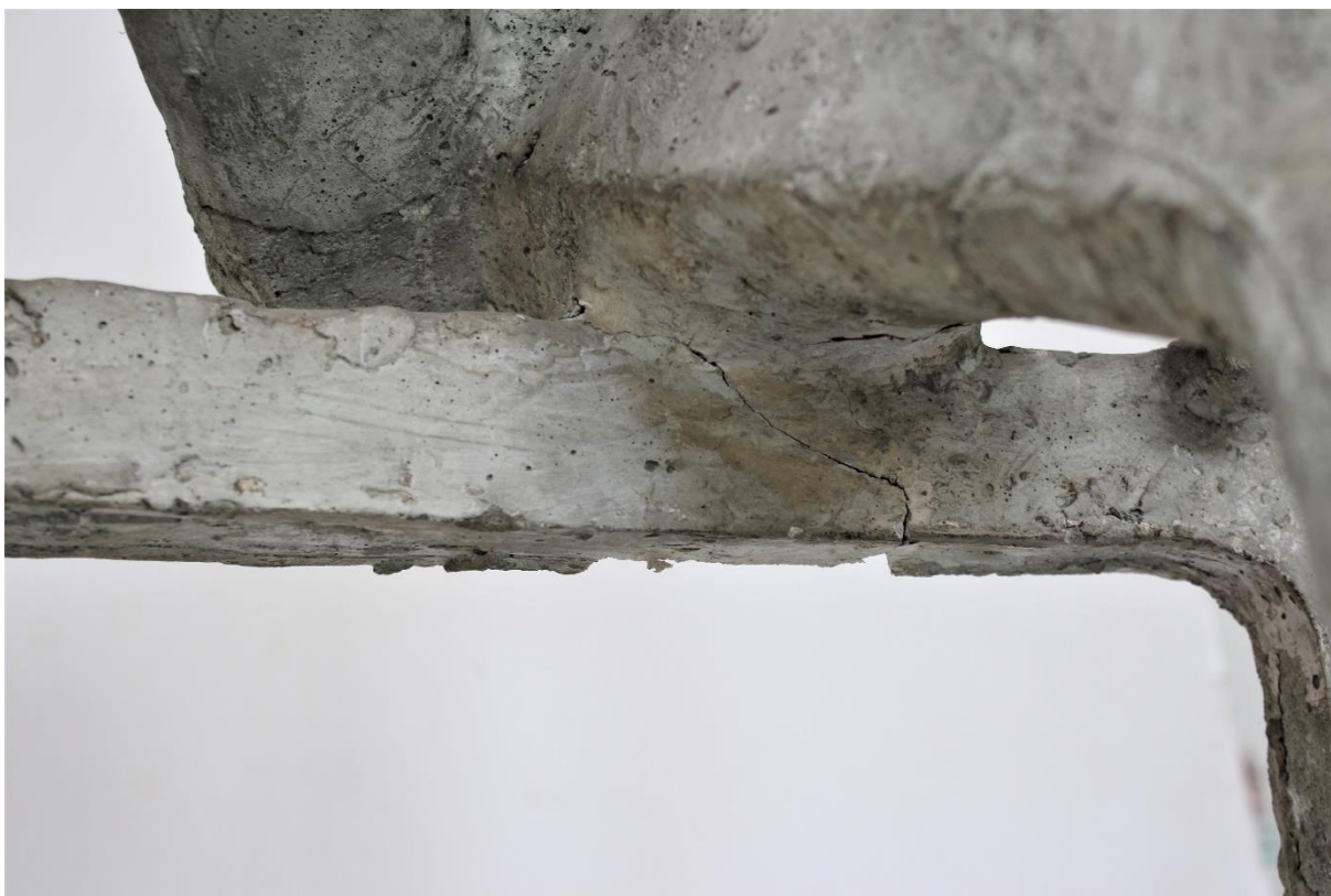
Obr. č. 22. Trhlina z přední strany z horní části překážky
