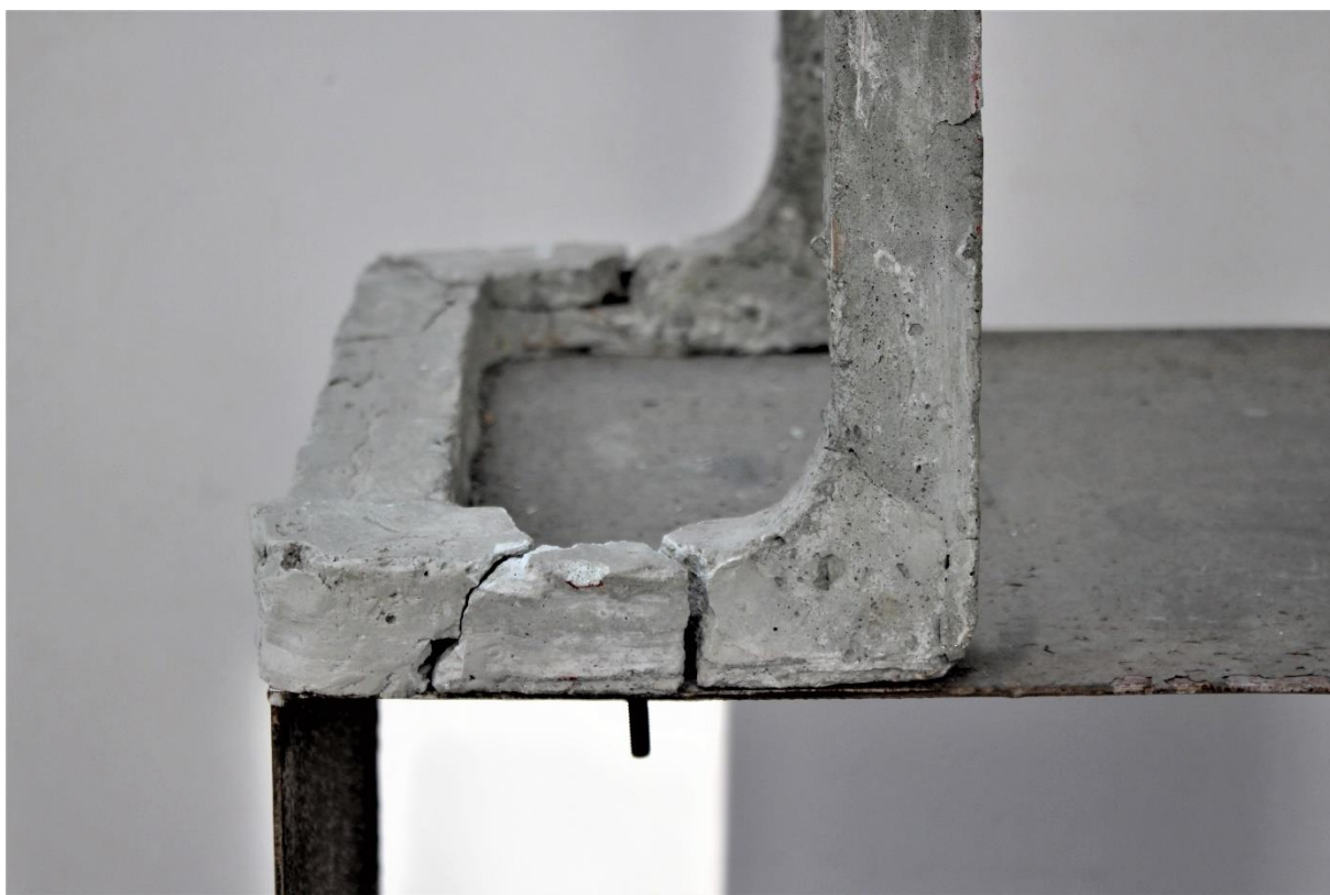
Obr. č. 24. Poškozená spodní část překážky
