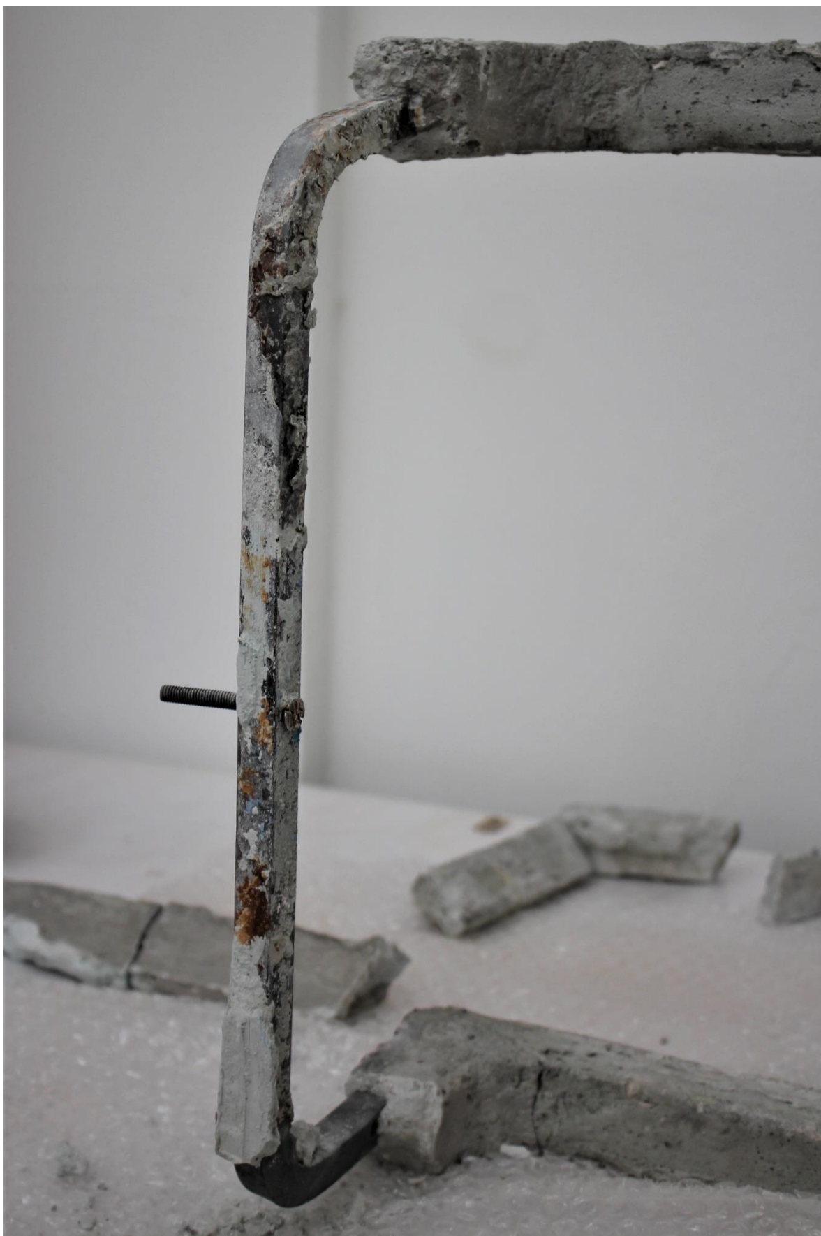
Obr. č. 37. Neošetřená vnitřní armatura ze spodní části překážky
