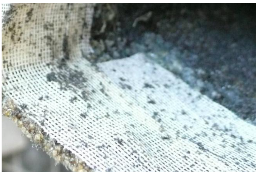
Obr. č. 77 Dokumentace, rentoaláž vnitřní strany kaučuku
