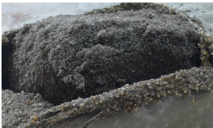
Obr. č. 16 Degradovaný původní Molitan
