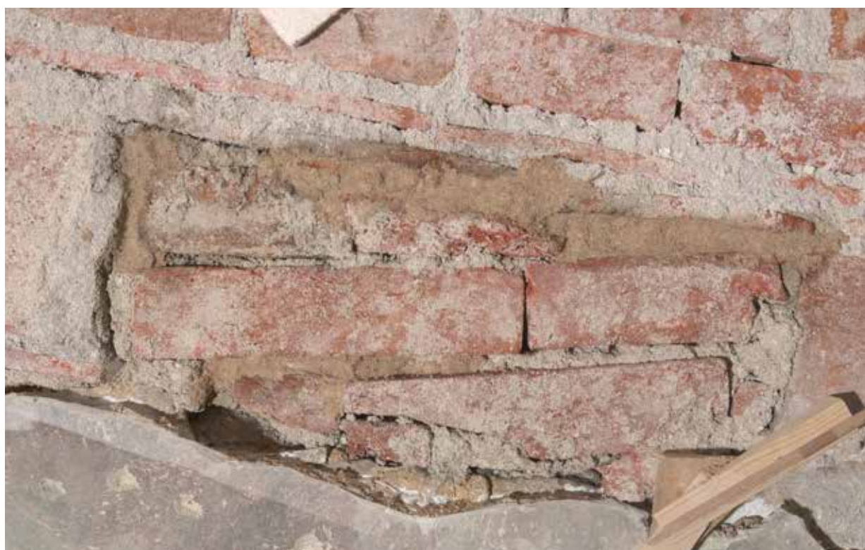
detail ve VIS vyzdění otvoru do komínu drobnými cihlami a maltou horní část - chybějící pás
