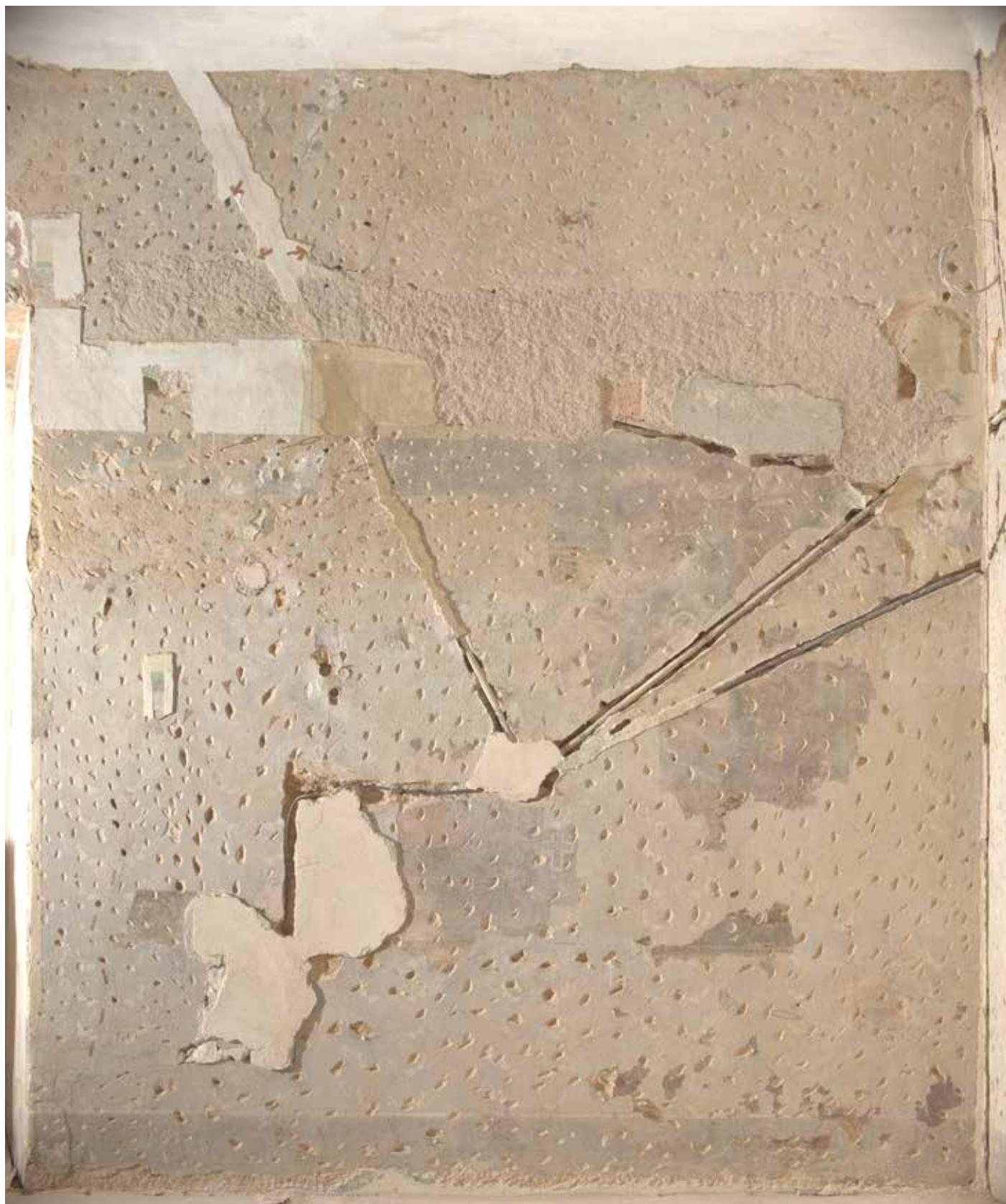
celek ve VISR po částečném odkryvu vrchních omítek a vyjmutí některých tmelů
