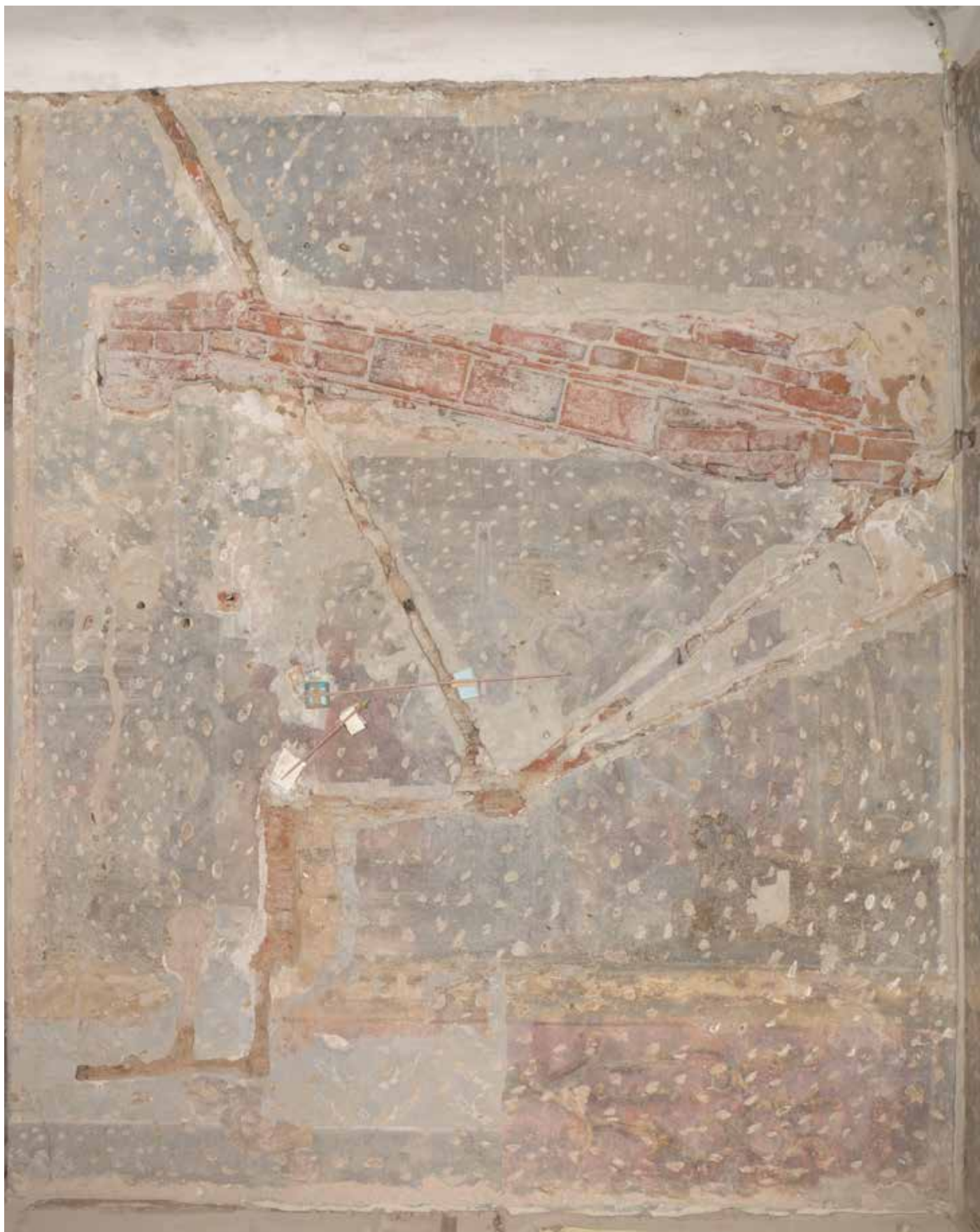
celek ve VIS po odstranění tmelů a z velké části odkryté šedého nátěru, průběh konsolidace
