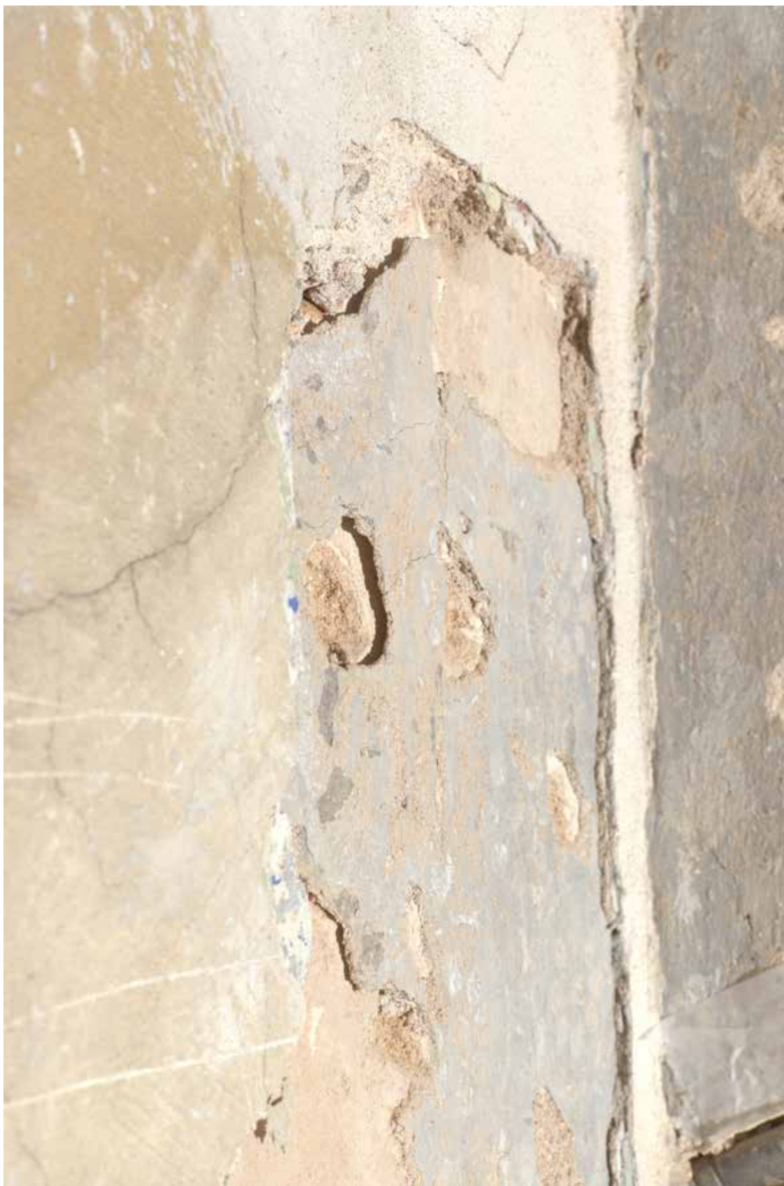
detail ve VIS uvolněná omítka s vydroleným intonakem pravá část
