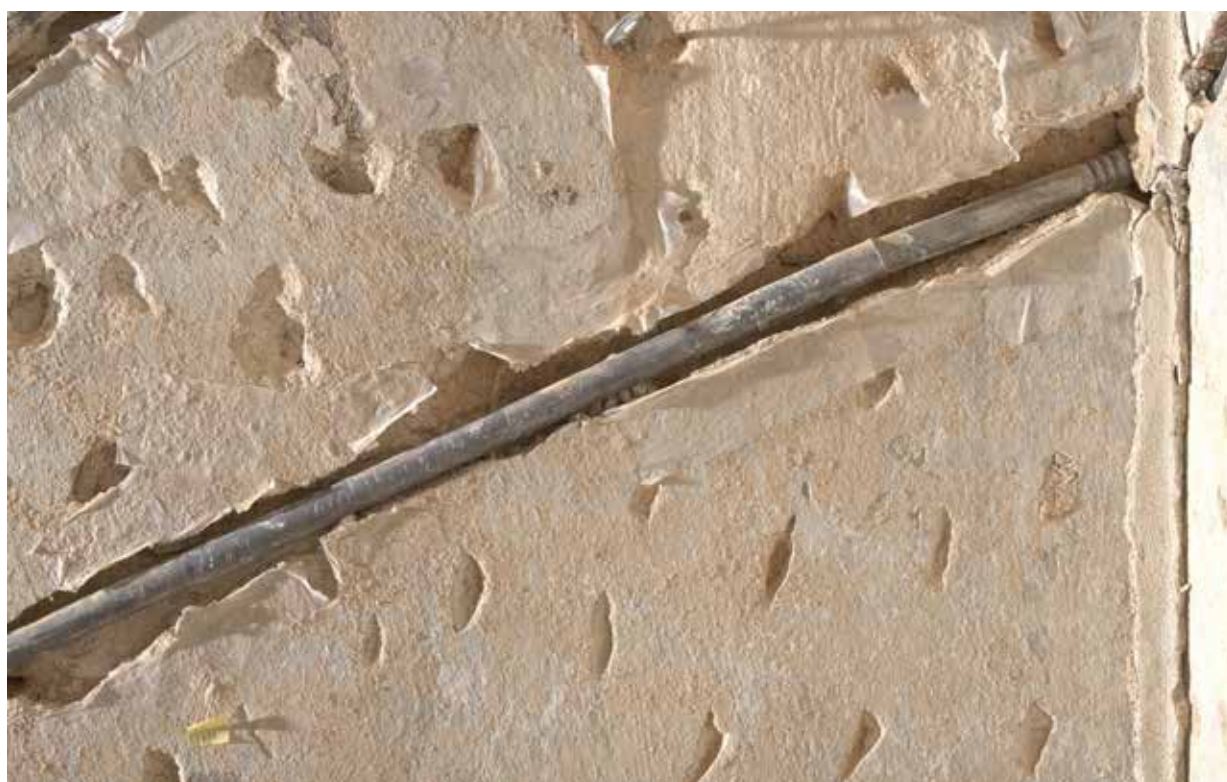
detail ve VIS a VISR odkryv elektřiny
