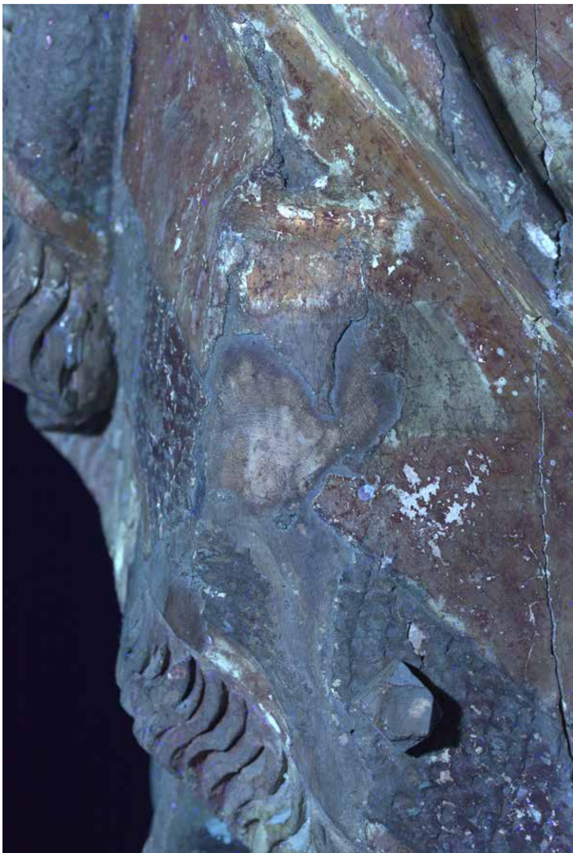
detail v UVL negativní sonda s nedočistěným zlacením a odkrytým dřevem
