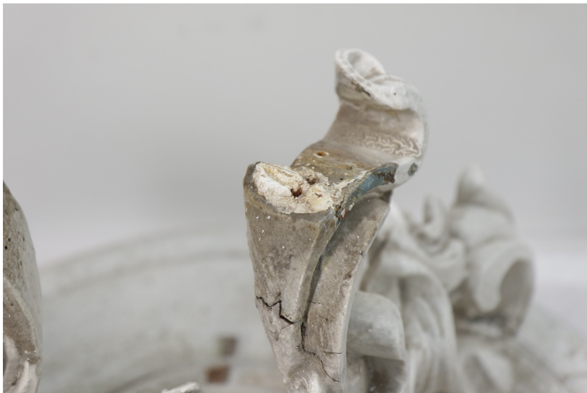
Obr. 35 detail poškození viditelného po demontáži podstavy
