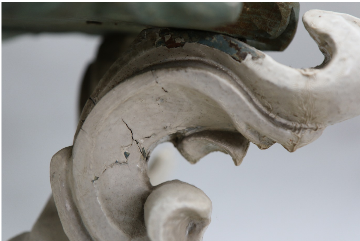
Obr. 17 stav díla před restaurováním – detail poškození
