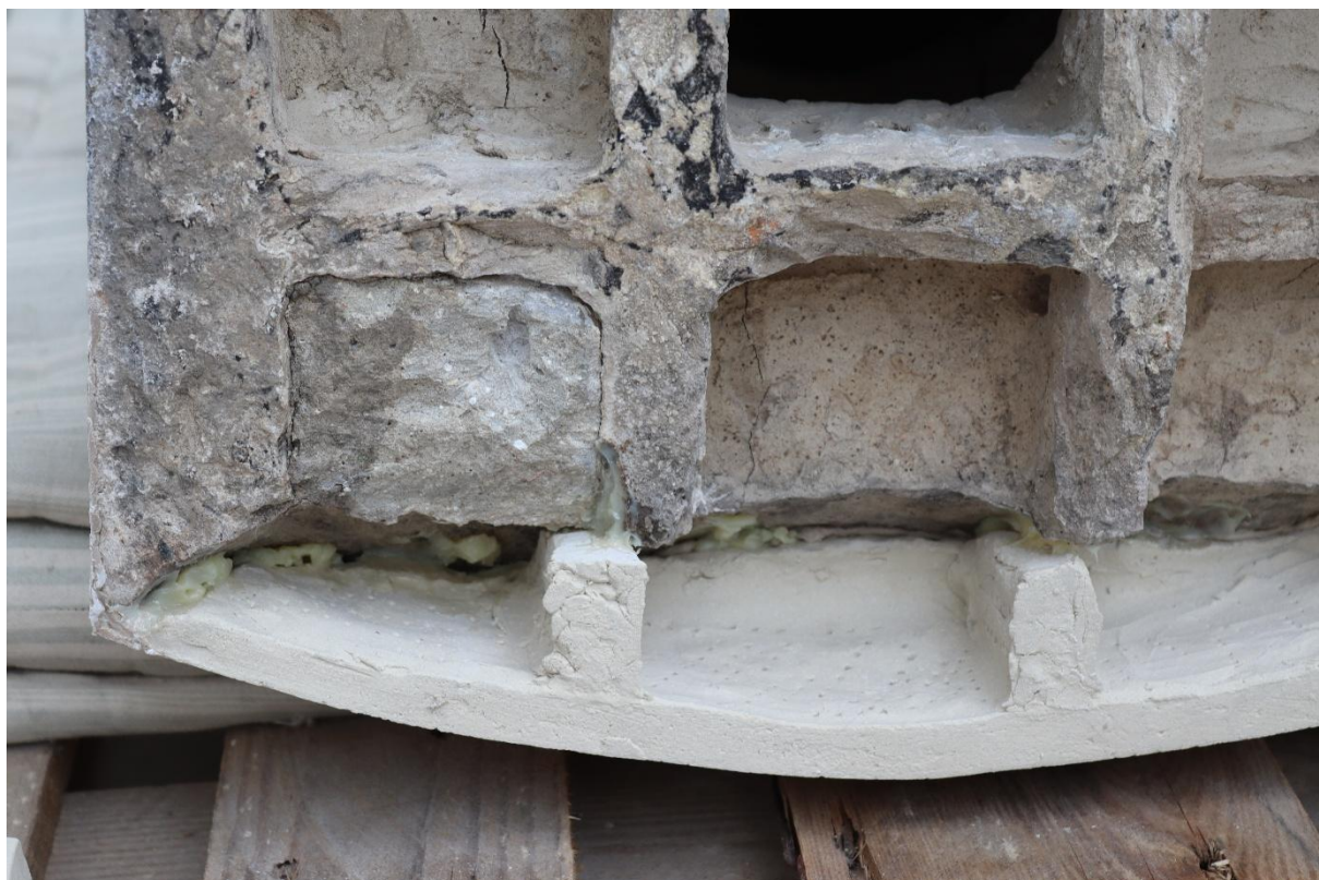
Obrázek 69 Stav před odejmutím cementové výplně za pomoci frézky
