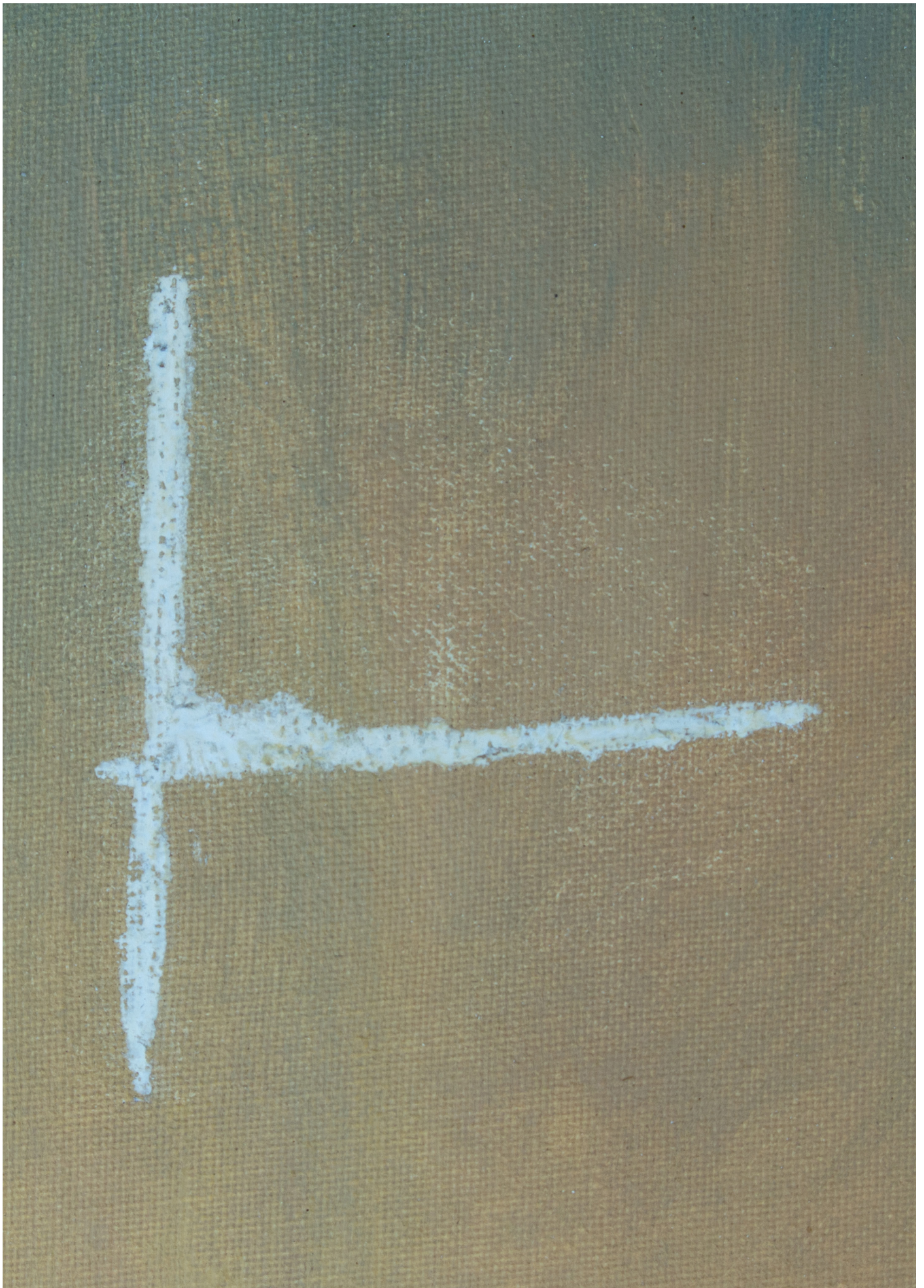
Defekt v podobě trhliny po tmelení křídlovým tmelem
