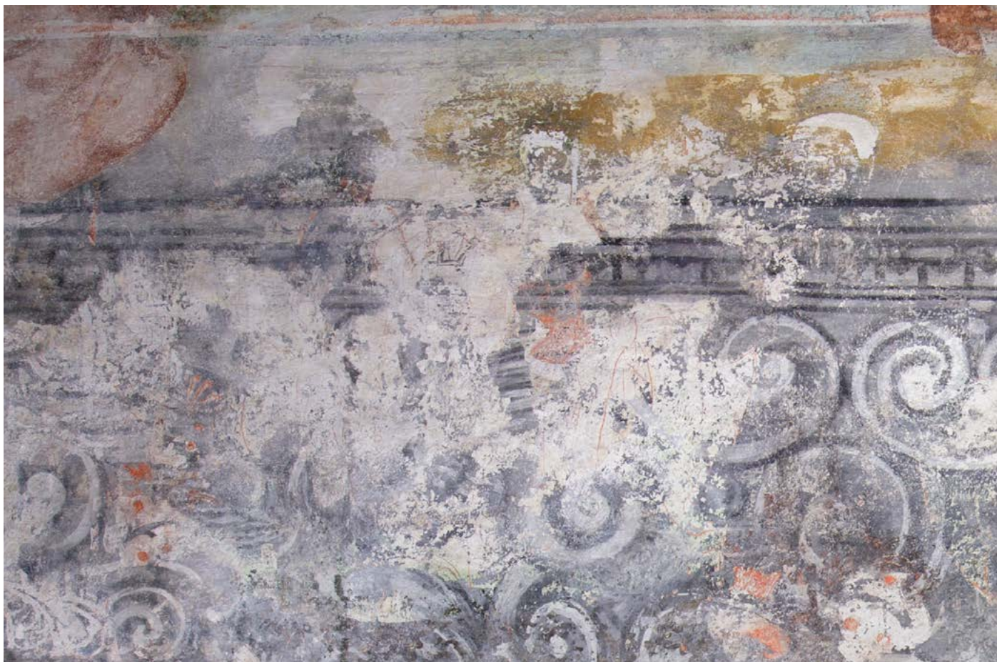
Stav po reštaurovaní, VIS, detail Ukrižovania prejavujúceho sa v staršej vrstve maľby (voľným okom ťažko rozpoznateľný)
