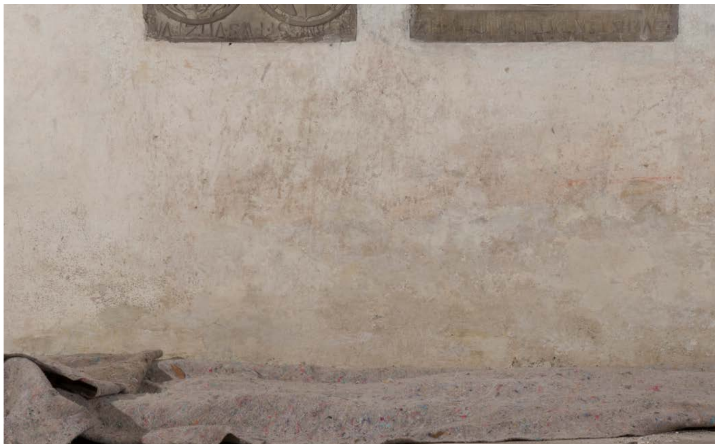
Stav po tmelení a retuši, detail , spodná časť steny (pod náhrobkami) súvisí s výmalbou z roku 1614, no už bez farebnej úpravy
