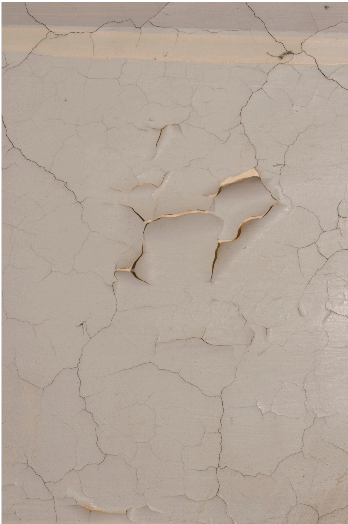
uvolněná barevná vrstva na stěně denní rozptýlené osvětlení
