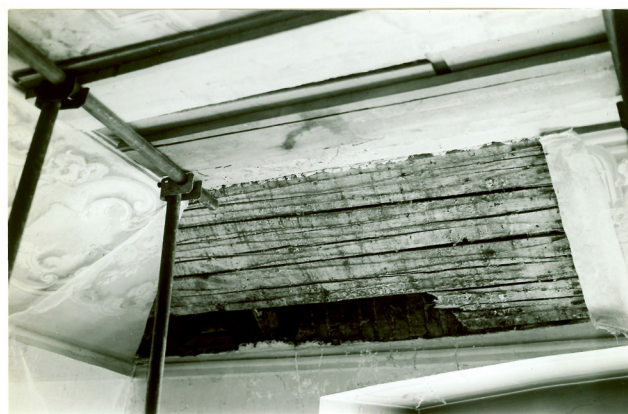
obr.23 rok 1986 - obnažená část dřevěného podbíjení na trémové konstrukci, tvořící strop Kapitulní síně
