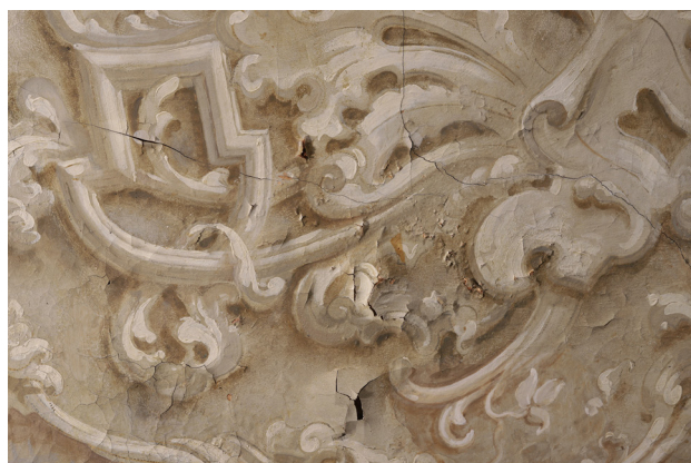
obr.29 detail zkrakelované barevné vrstvy ve středu jižní části stropu
