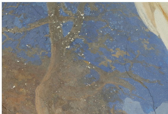
obr.2.1 degradace barevné vrstvy uvolňující se od podkladu
