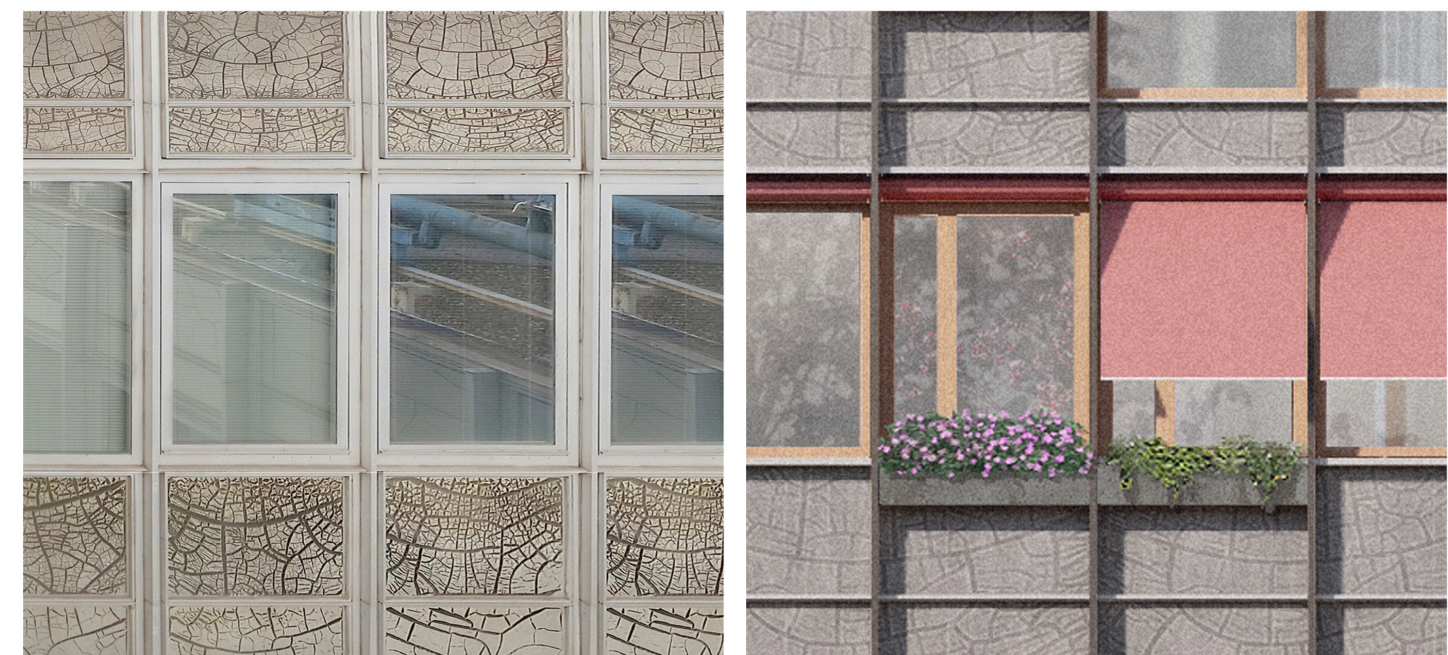
PŮVODNÁ FASÁDA S DEGRADOVANOU POPRASKANOU FÓLIOU NOVÉ HLINÍKOVÉ FASÁDNE PANEĽY S FRÉZOVANÍM MOTÍVU POPRASKANEJ FÓLIE
