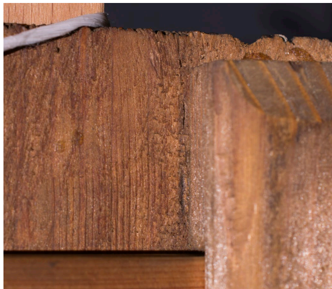
Detail drobné praskliny způsobené nevhodnou parketáží
