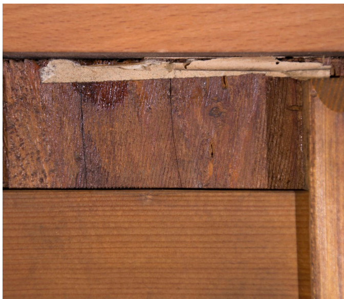
Detail odpadlého štítku, zbytky lepidla Detaily prasklin
